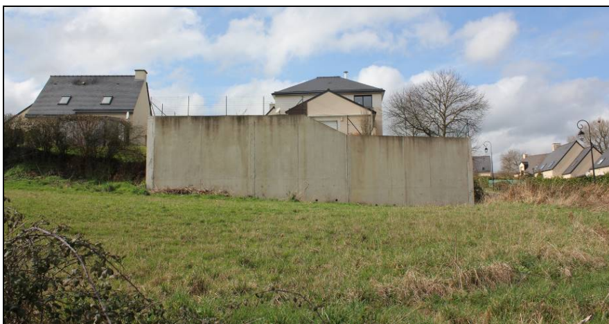
Mur de soutènement et clôture particulièrement imposants et non intégrés à leur contexte paysager.
